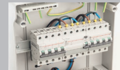
Posibilidad de instalar terminales de neutro y tierra Ready to install the terminal blocks for neutral and earth connection
